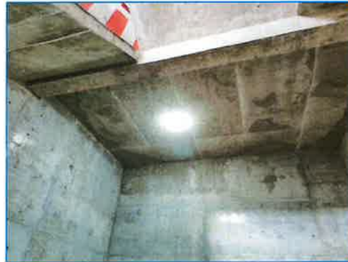
照明永临结合
